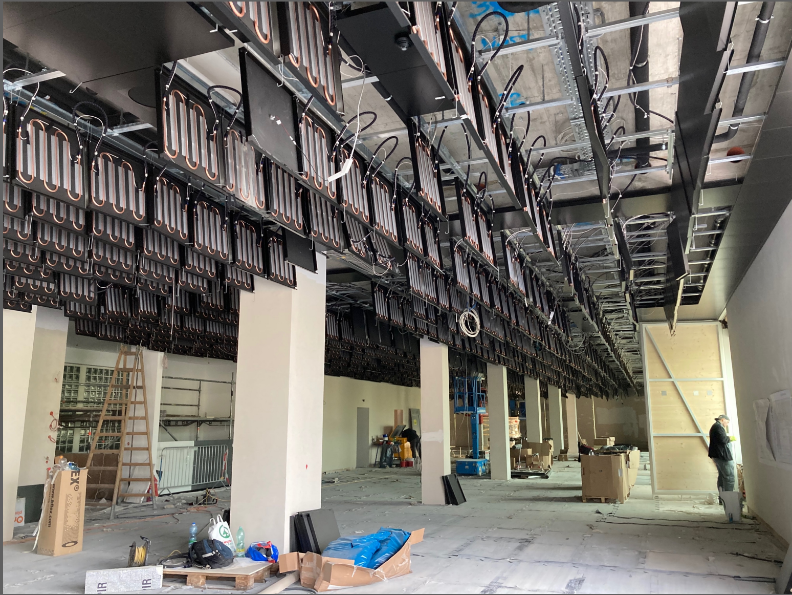
Kühldecke in der Dauerausstellung, Foto Kollektiv Fischka, März 2023
