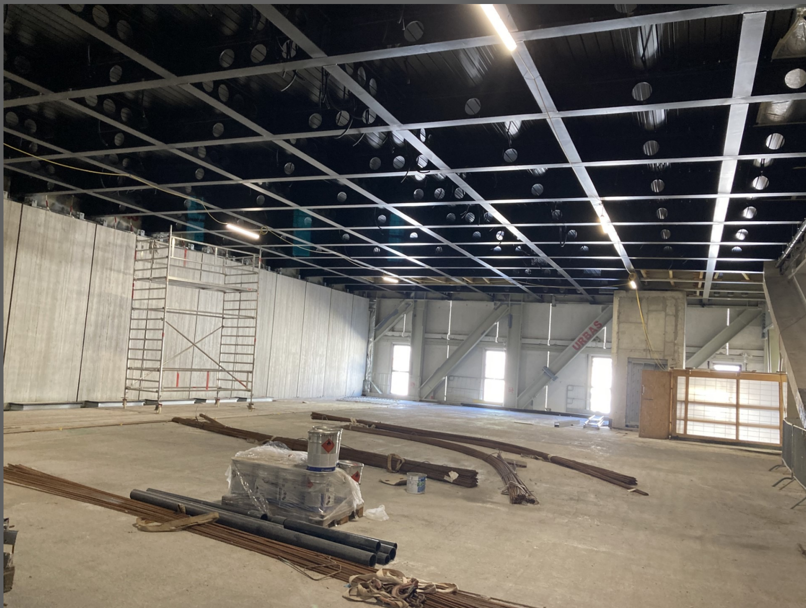
Sonderausstellungsgeschoß: Fußboden, Decken- und Wandheizung
