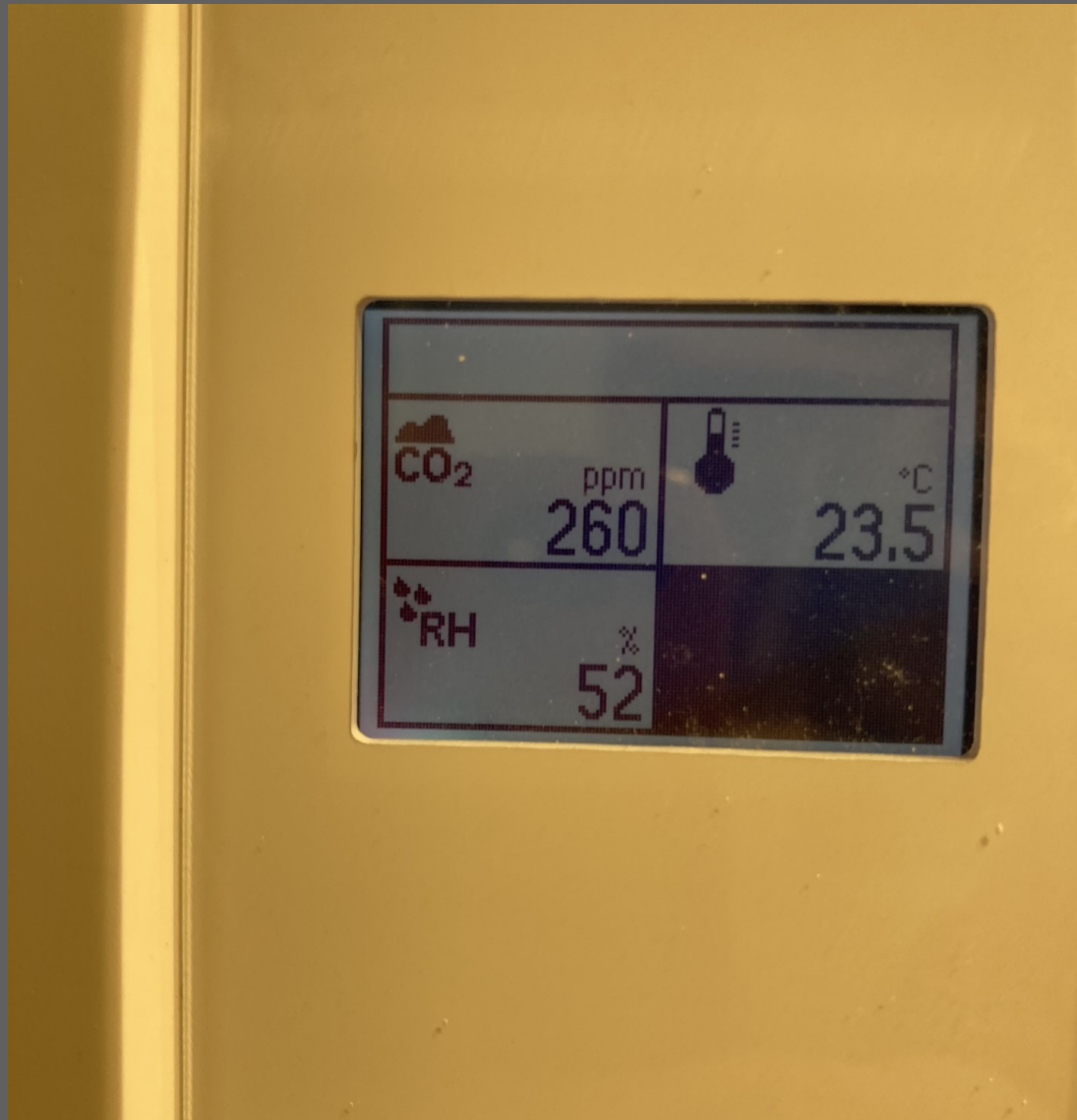
Datenlogger nach der Umsetzung des Klimakorridors, Aufnahme 23.8.2023
